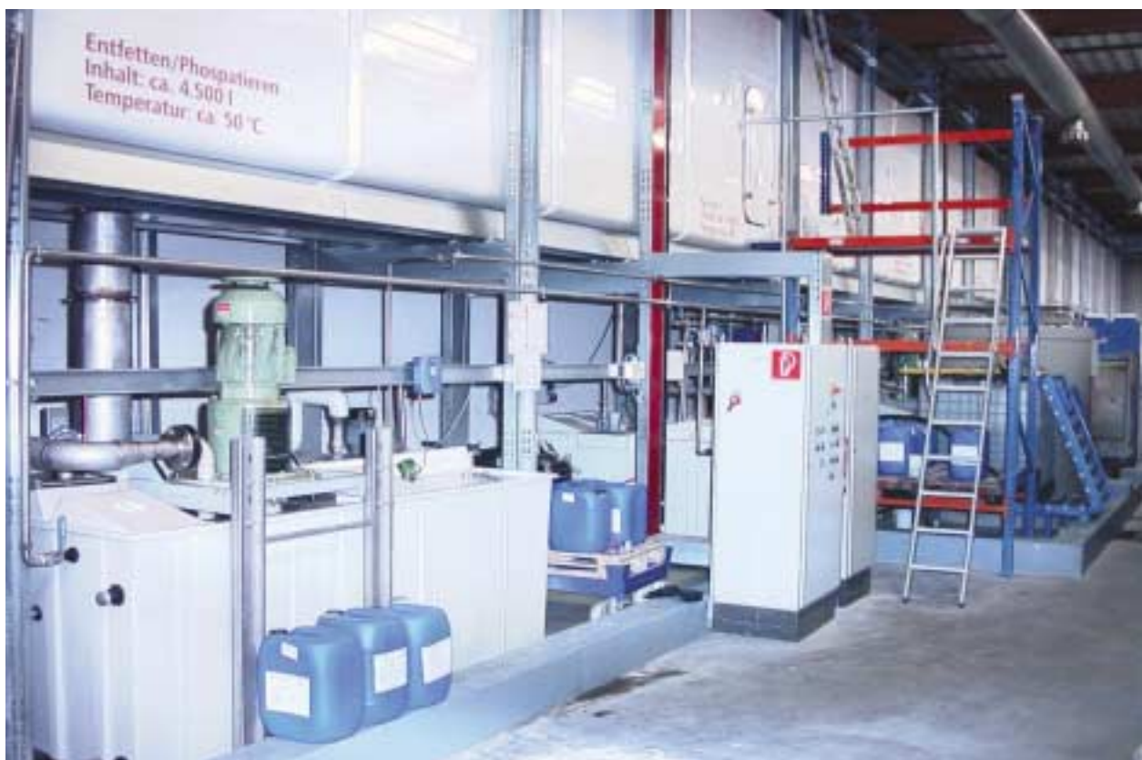
Blick auf die neue 7-Zonen-Spritzanlage
