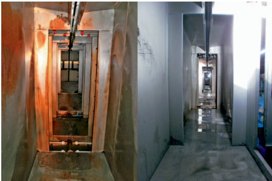
Blick in die Vorbehandlungsanlage vor (links) und nach der Reinigung (rechts)
